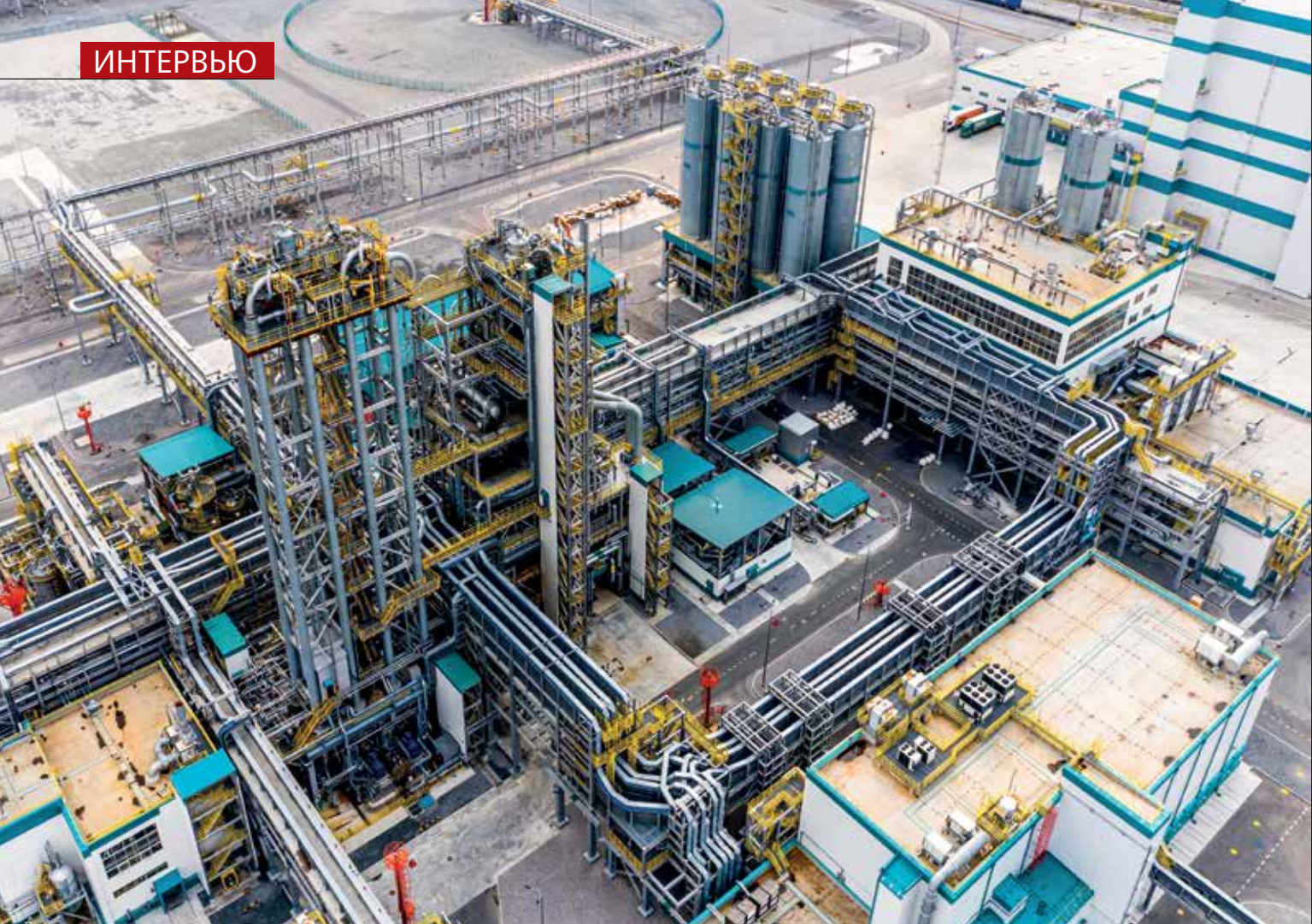
Установка полипропилена мощностью 500 тыс. т в год на объекте «ЗапСиб II» в Тобольске, спроектированная thyssenkrupp Industrial Solutions.
